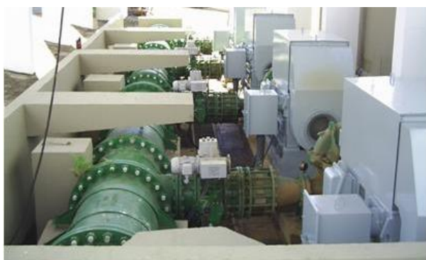
Figura 3 - Captação de água bruta - Ribeirão Piancó.
