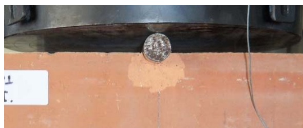
Detalhe da região de ruptura por esmagamento
