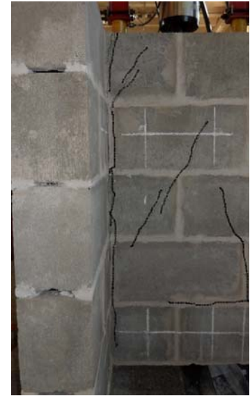
(c) Fissuração no modelo físico
