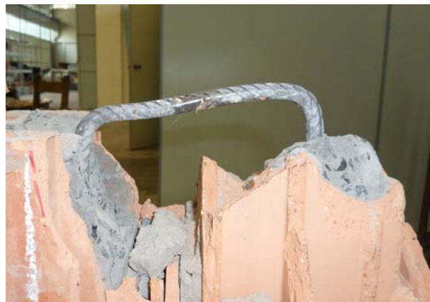
(b) Detalhe da deformação do grampo.
