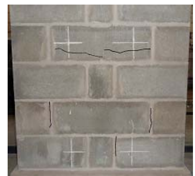
(c) Fissuração no modelo físico
