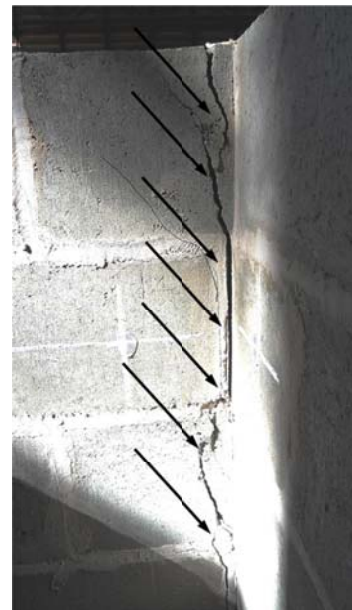
(b) Fissuras de cisalhamento na interface
