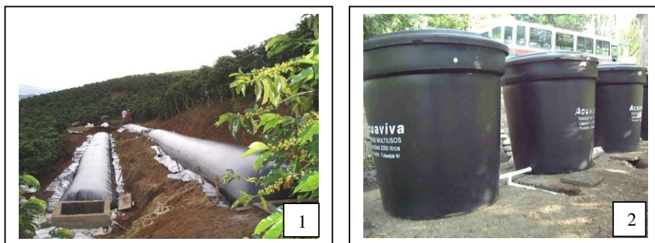
Figura 1.18. Reactores hidrolíticos. 1. En plastilona. 2. En polietileno.
