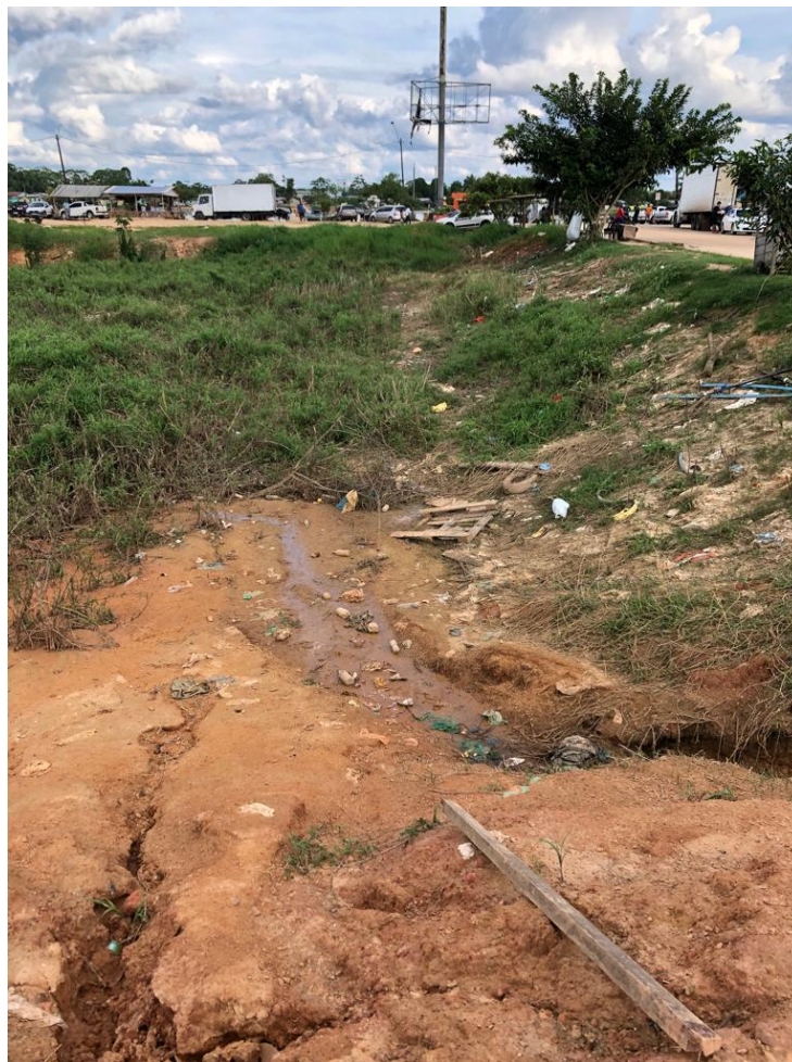
Figura 5. Degradação por Erosão Hídrica nas proximidades do Rio Juruá.
