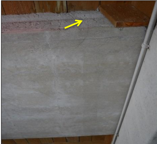
(a) Narrow crack (&lt;math&gt;&lt;0.5\text{ mm}&lt;/math&gt;)
